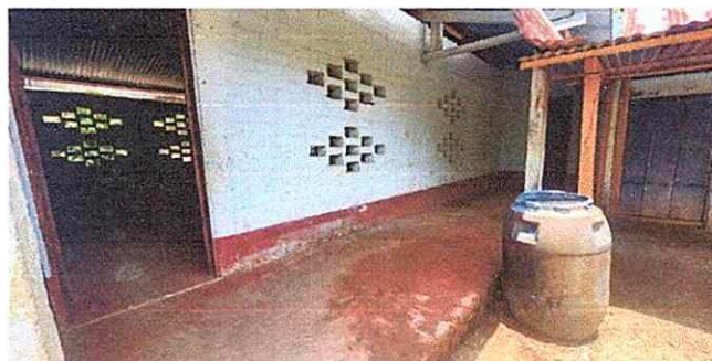
Foto 2: Evidencia de la escases de ventanas.
